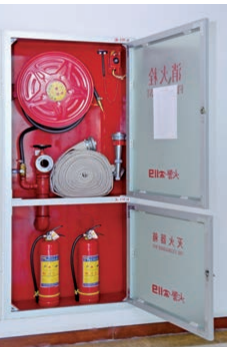
图7-10 建筑物内的消防设施
